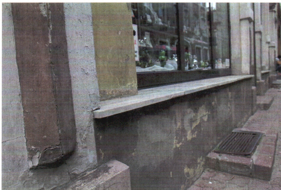
Fot. 20. Elewacja frontowa – przyziemie. Widoczne zniszczenia tynków i powłok malarskich.
