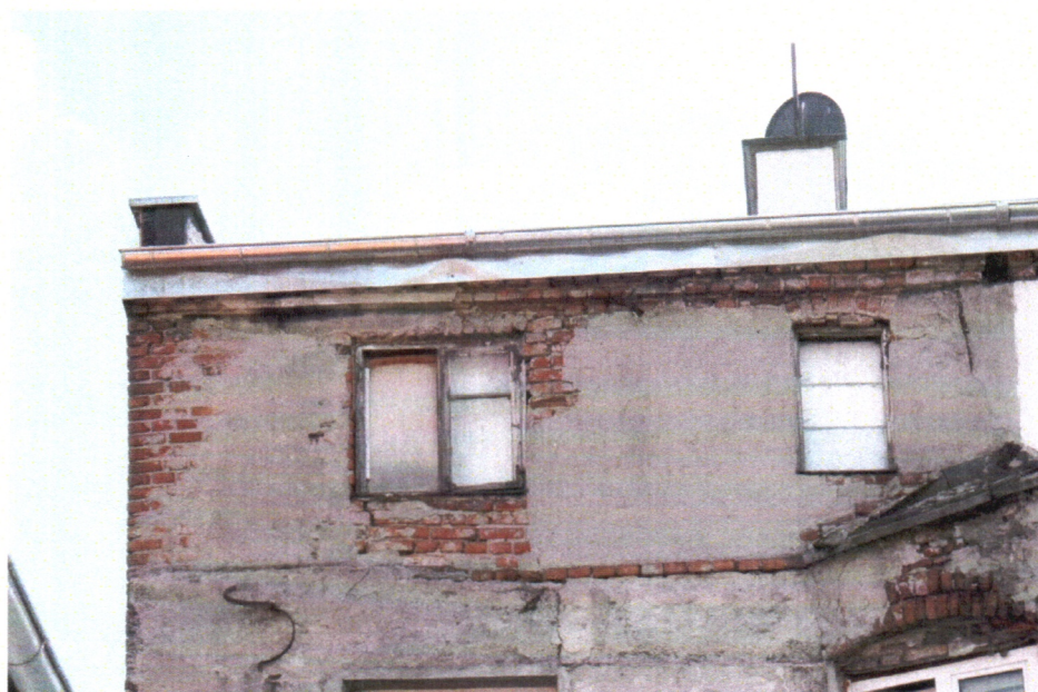
Fot. 30. Elewacja podwórzowa. Kondygnacja poddasza wydzielona płasko ułożoną cegłą. Widoczny oryginalny otwór okienny z łukowym nadprożem oraz wtórny lub wtórnie rozkuty prostokątny otwór okienny. Znaczne ubytki wypraw tynkarskich oraz zaprawy wiążącej cegły muru. Widoczne spękania muru.
