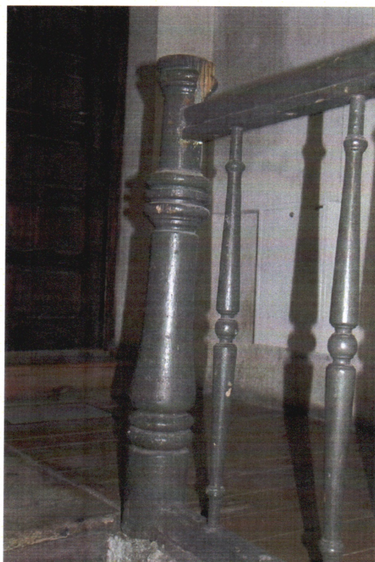
Fot. 44. Uszkodzony słupek początkowy balustrady podestu. Brak tralki w balustradzie
