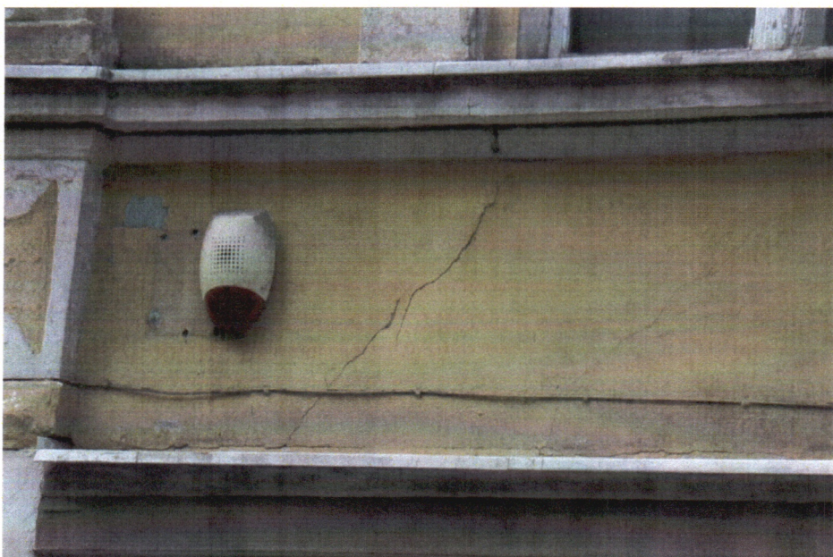
Fot. 6. Elewacja frontowa – pas podokienny. Widoczne spękania muru oraz instalacje poprowadzone po elewacji.
