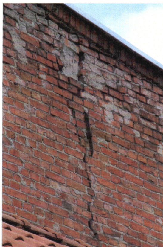
Fot. 28. Elewacja boczna – widoczne spękania muru oraz brak wypraw tynkarskich.
