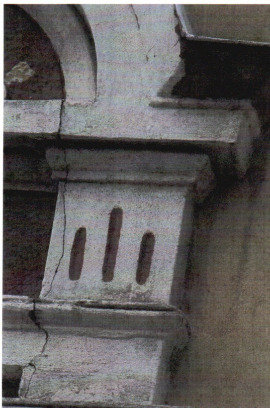
Fot. 16. Elewacja frontowa – fragment naczółka nadproża okiennego. Widoczne wtórne białe i brunatne powłoki malarskie oraz spękania wypraw tynkarskich.
