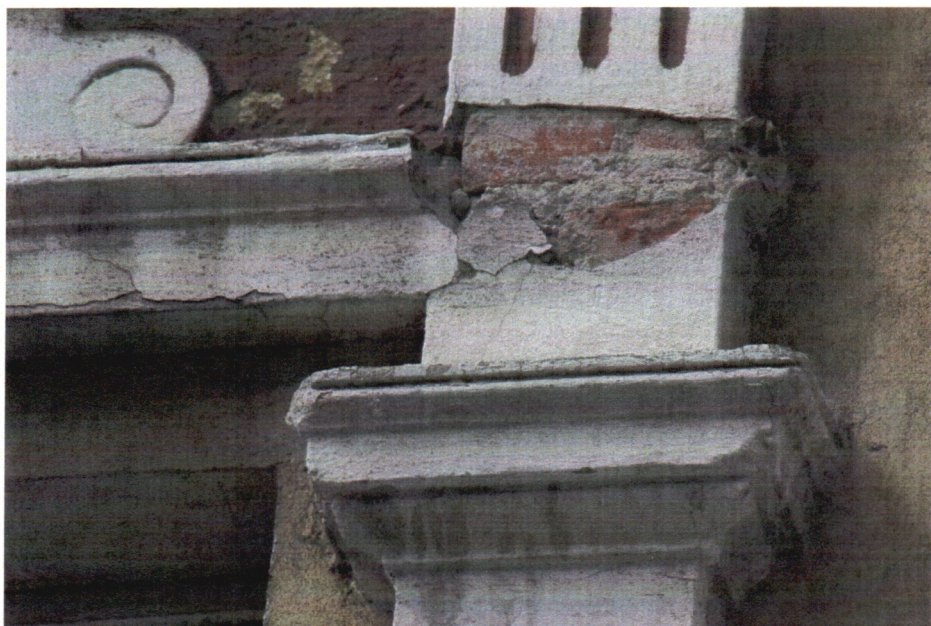
Fot. 12. Elewacja frontowa – fragment nadproża okiennego. Widoczne spękania i odspojenia tynków odsłaniające mur ceglany.
