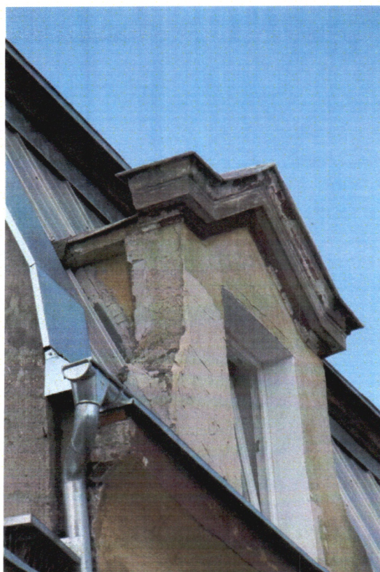
Fot. 24. Elewacja frontowa – widoczny zły stan zachowania wypraw i detalu architektonicznego lukarny w połaci dachowej.
