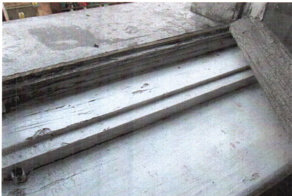
Fot. 57. Oryginalne okno I piętra od strony wewnętrznej – widoczny zły stan zachowania ramiaków i okapnika
