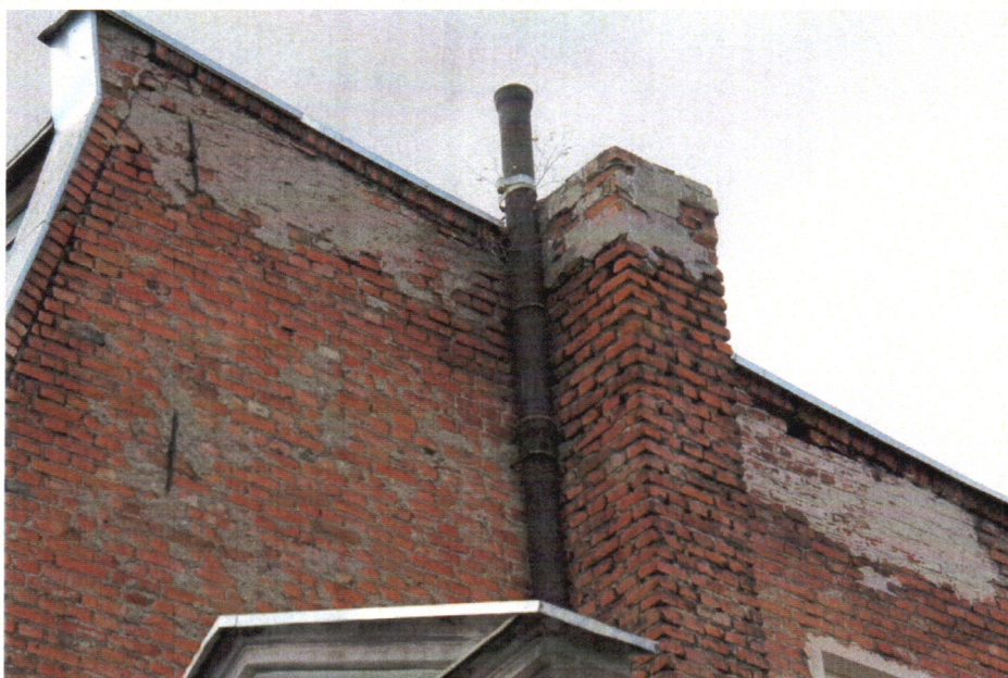
Fot. 26. Elewacja boczna z wyprowadzeniami murowanego komina oraz współczesnego, metalowego. Elewacja niemal w całości pozbawiona tynków. Okno wykute wtórnie.
