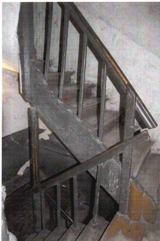
Fot. 47. Drewniane schody I piętra. Balustrady częściowo wtórne. Widoczne przybicie słupka do pochwyty oraz przycięcie słupka kończące balustradę.
