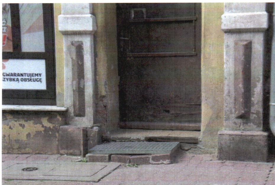
Fot. 22. Elewacja frontowa – dolna część wejścia głównego. Widoczny brak stopnia wejściowego.
