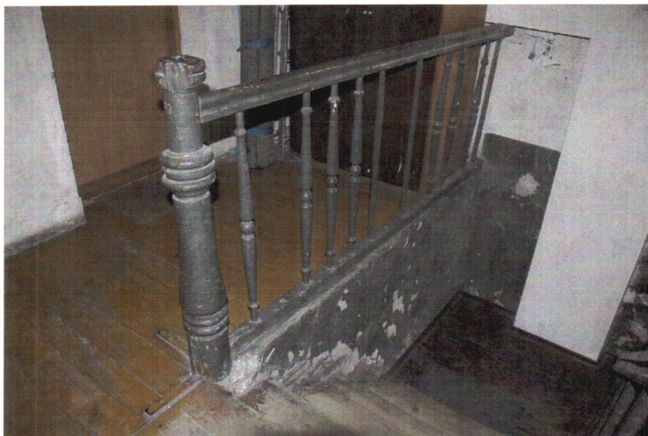
Fot. 43. Klatka schodowa – schody prowadzące na piętro II . Widoczna tralkowa barierka podestu z przyciętym zwieńczeniem słupka początkowego i ubytkami tralek
