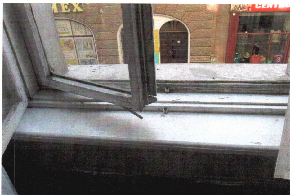
Fot. 58. Oryginalne okno I piętra od strony wewnętrznej – widoczny zły stan zachowania drewna, mimo wielu warstw powłok malarskich
