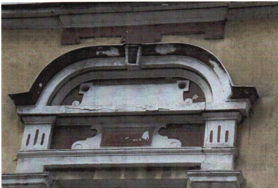
Fot. 15. Elewacja frontowa – naczótek nadproża okiennego. Widoczne wtórne białe, brunatne i grafitowe powłoki malarskie.
