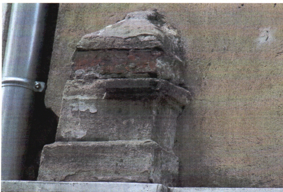
Fot. 18. Elewacja frontowa - detal architektoniczny w postaci stylizowanej steli flankujący otwór okienny I piętra. Widoczne znaczne zniszczenia substancji zabytkowej oraz próby napraw.
