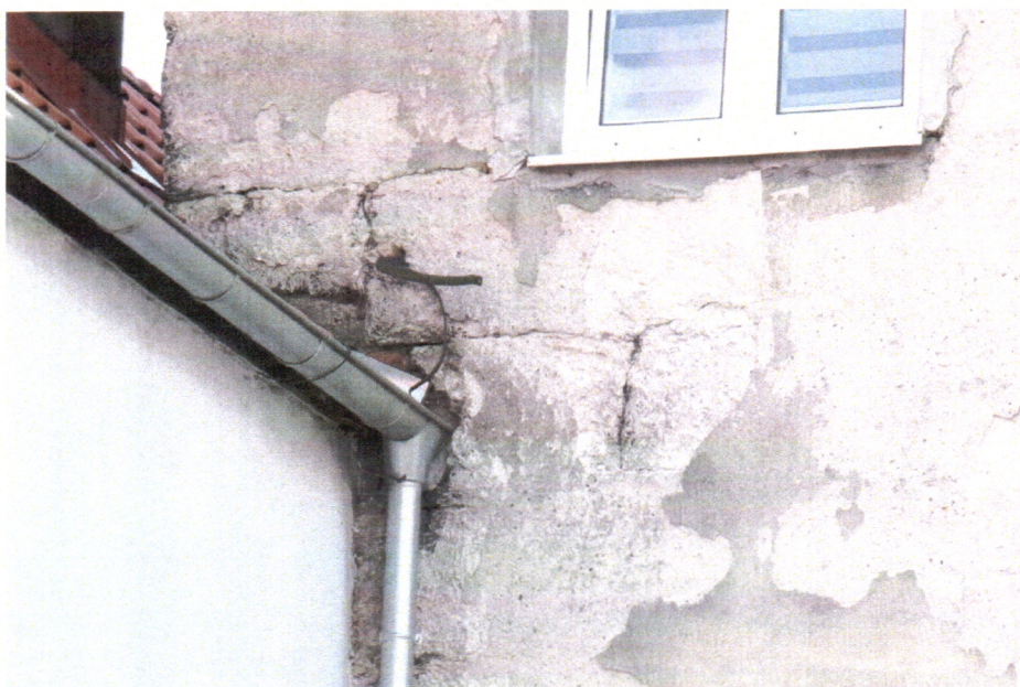
Fot. 34. Elewacja podwórzowa. Widoczny źle opracowany styk odprowadzenia wód opadowych instalacji rynnowo-spustowej przybudówki z murem budynku głównego, pod poziomem okien II piętra.
